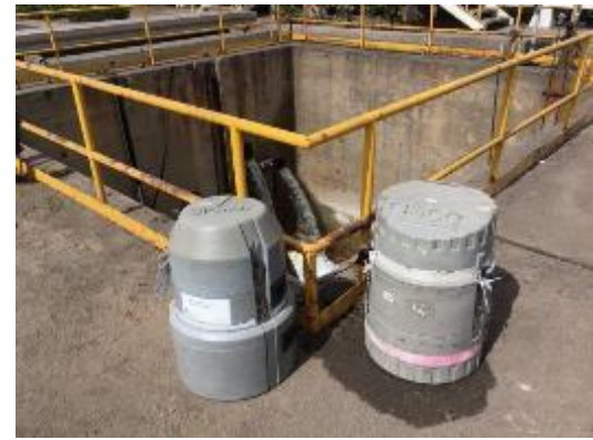
Anexo Imagen 4: Equipos muestreadores instalados en sector descarga.
