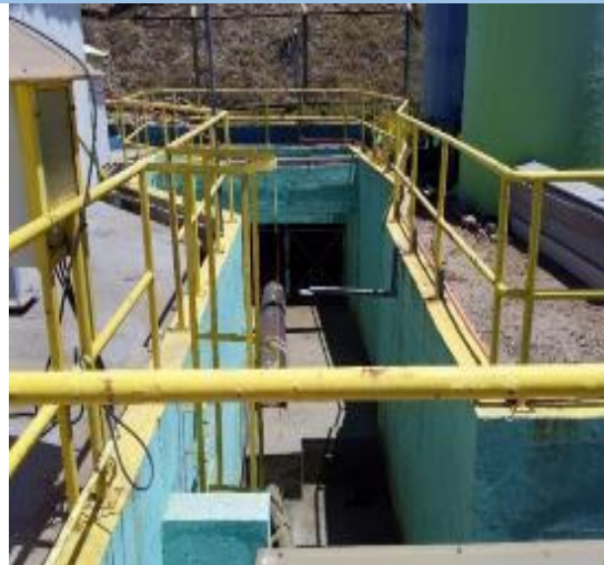
Anexo Imagen 39: Sector de conexión con emisario submarino.
