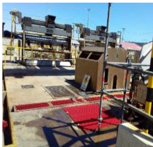
Anexo Imagen 21: Sector de sistemas de filtros por rejas (fijas y rotatorias).
