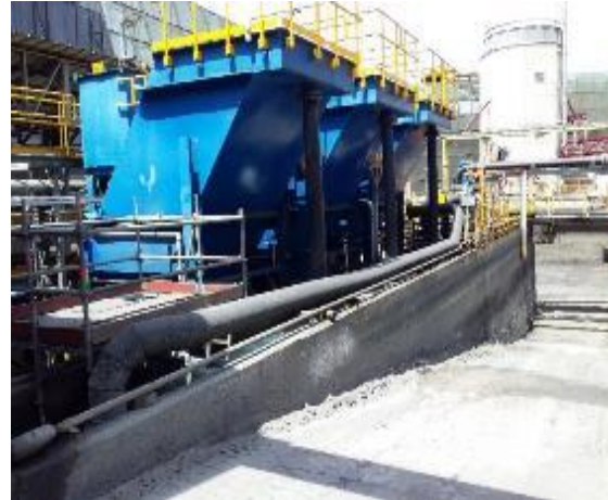
Anexo Imagen 17: Vista lateral de planta, de líneas de descarga de efluentes tratados.
