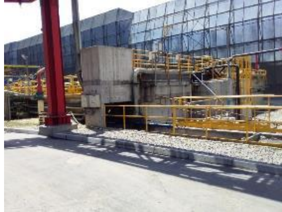
Anexo Imagen 11: Vista ampliada de planta de tratamiento tipo "BAHS".
