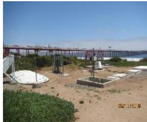
Anexo Imagen 47: Instalaciones de Planta de Tratamiento de Aguas Servidas.
