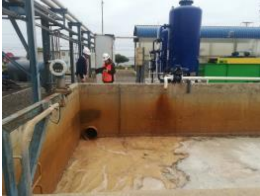
Anexo Imagen 65: Piscina decantadora N° 301, vaciada y sin flujo de efluentes.
