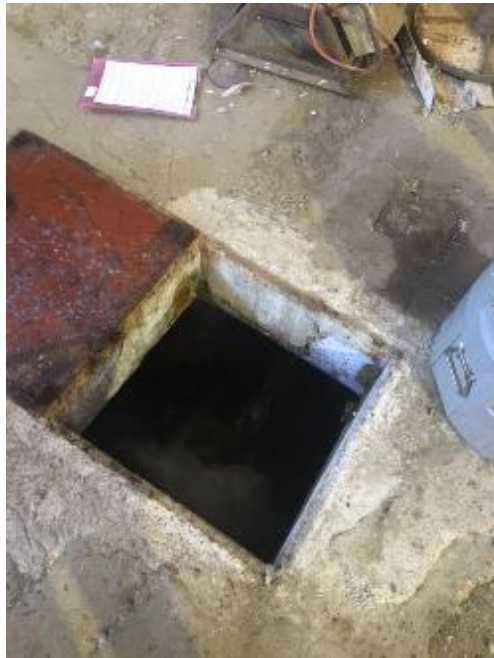
Anexo Imagen 73: Apertura de cámara de muestreo. (sector sala compresores)
