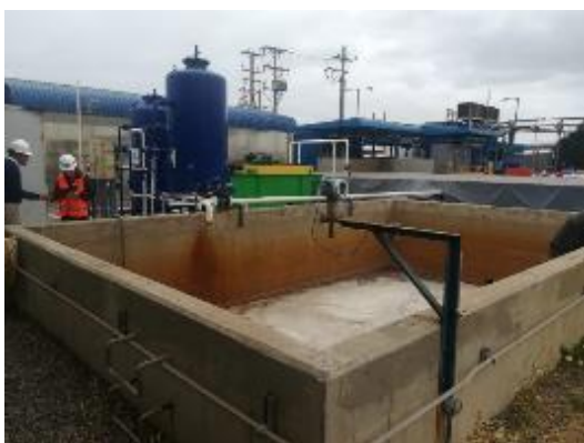
Anexo Imagen 61: Piscina 301 de efluentes de planta de tratamiento (sector "TPI").
