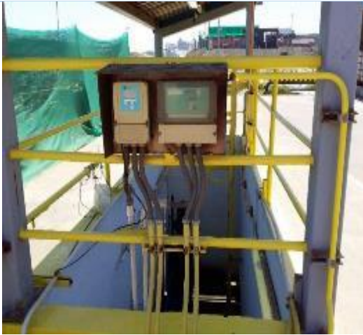
Anexo Imagen 36: Paneles medición pH y T°, anexo a cámara de descarga.
