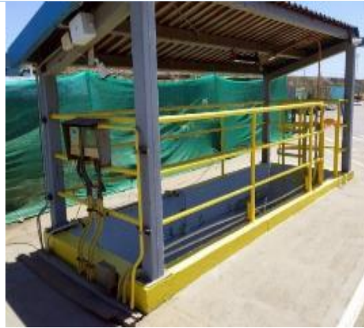
Anexo Imagen 37: Sector de Cámara de muestreo (canal Parshall™ modelo venturi)
