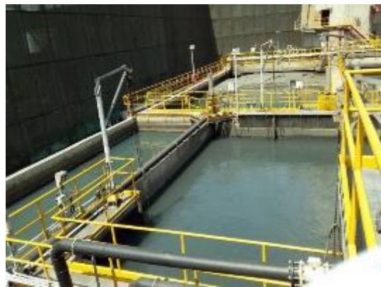
Anexo Imagen 13: Vista panorámica, piletas de decantación de planta BAHS.
