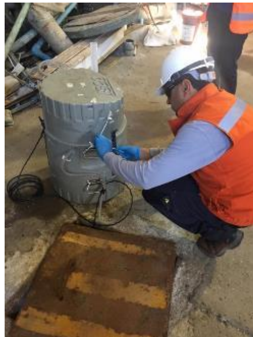
Anexo Imagen 76: Instalación de sellado de seguridad al equipo automático.
