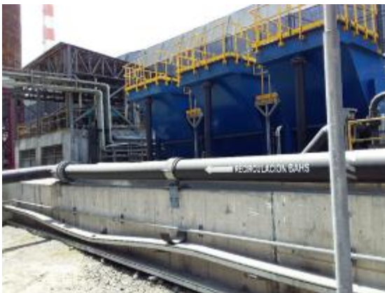
Anexo Imagen 12: Tramo posterior, salida de efluentes de la planta BAHS.
