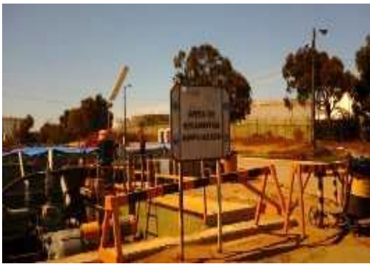
Anexo Imagen 51: Área de planta de efluentes, Sector "Ampliación".
