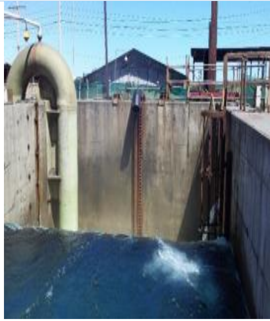
Anexo Imagen 27: Pozo de descarga de Riles. (pozo sello)
