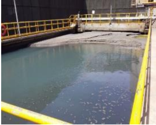
Anexo Imagen 14. Piscina decantación oriente, con efluentes en proceso de decantación de sólidos.
