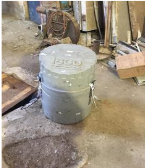
Anexo Imagen 77: Equipo automático instalado, con monitoreo continuo en cámara descarga de Riles.
