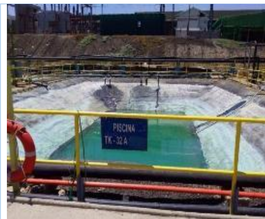
Anexo Imagen 32: Piscina de recepción de afluentes de procesos de refinería (planta ácido).
