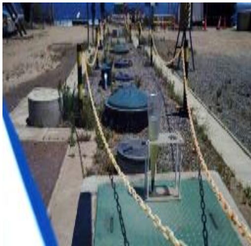
Anexo Imagen 59: Instalaciones de Planta Tratamiento Aguas Servidas (PTAS), con descarga hacia cámara de muestreo para Riles.
