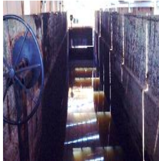
Anexo Imagen 56: Niveles de efluentes al interior de separador AP N° 2.
