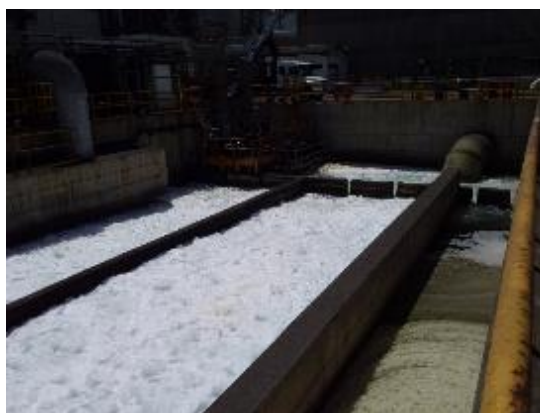
Anexo Imagen 9: Piscinas de aireación-desulfurización, previa descarga.
