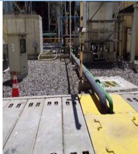
Anexo Imagen 25: Descarga final de efluentes planta tratamiento Riles, hacia al emisario.
