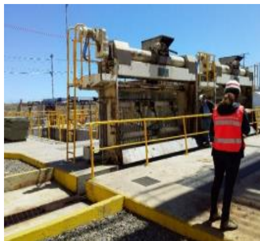
Anexo Imagen 19: Inspección a sistemas de filtros con rejas mecánicas
