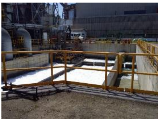
Anexo Imagen 8: Instalaciones de piscinas de aireación y desulfurización, zona descarga.
