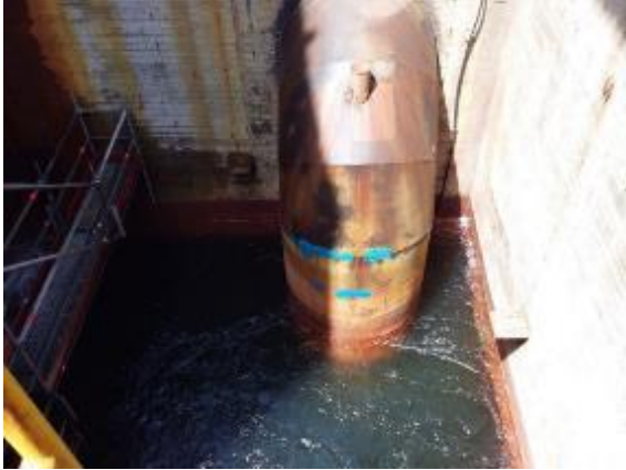
Anexo Imagen 10: Ducto de aducción de mar, (pozo intake).
