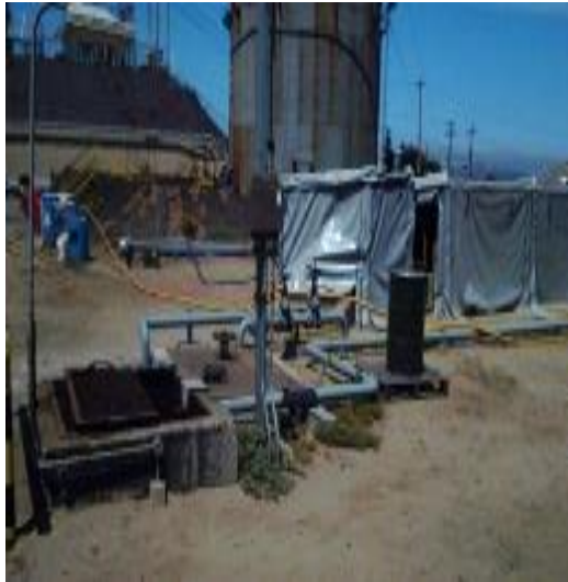
Anexo Imagen 55: Vista ampliada. Separador API N° 2 cubierto con lona.
