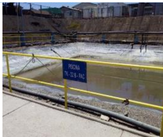
Anexo Imagen 33: Piscina de recepción de afluentes desde lavado de cátodos de la refinería (TK-32B - PAC).
