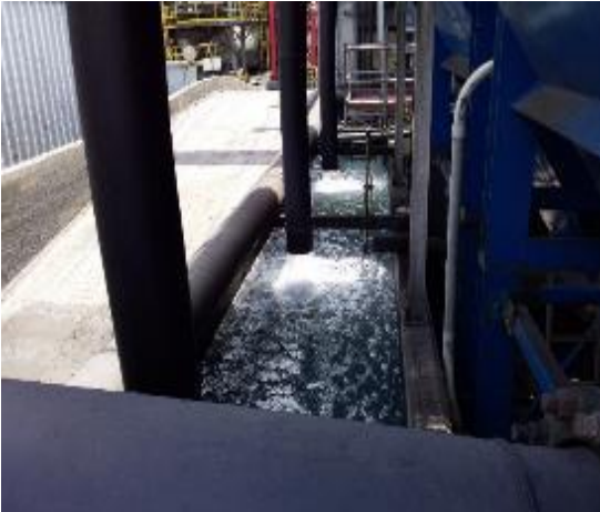
Anexo Imagen 16: Líneas y canal de descarga final de Riles tratados.
