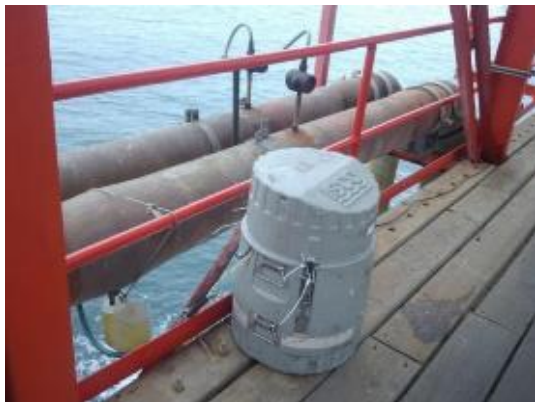
Anexo Imagen 70: Equipo muestreador automático instalado al sistema habilitado por empresa.
