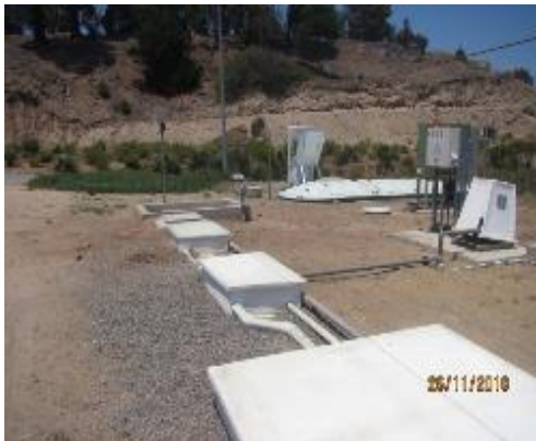
Anexo Imagen 46: Vista de instalaciones de Planta de Tratamiento de Aguas Servidas.
