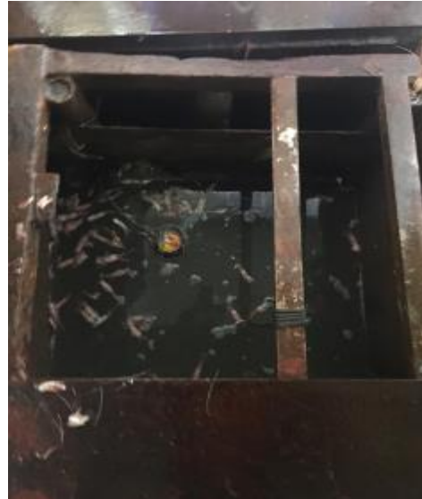
Anexo Imagen 80: Verificación de cámara de recepción de agua residual de proceso. (sala producción)
