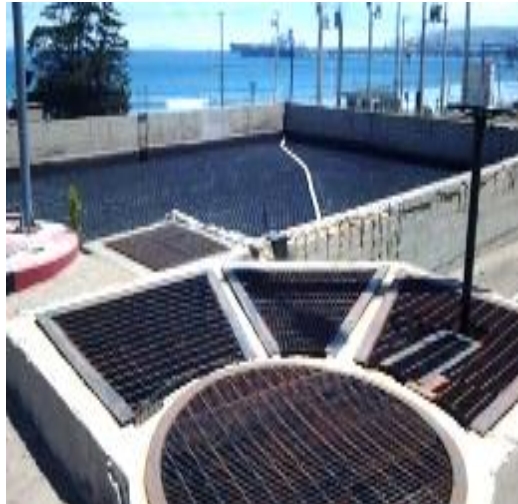
Anexo Imagen 57: Cámara recolección aguas lluvias y Laguna de Estabilización, recubierta en su superficie con implementos "hexacover".
